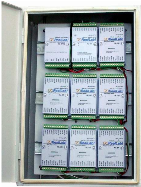
Рис.1. Внешний вид шкафа с аппаратурой системы "Грейн".
